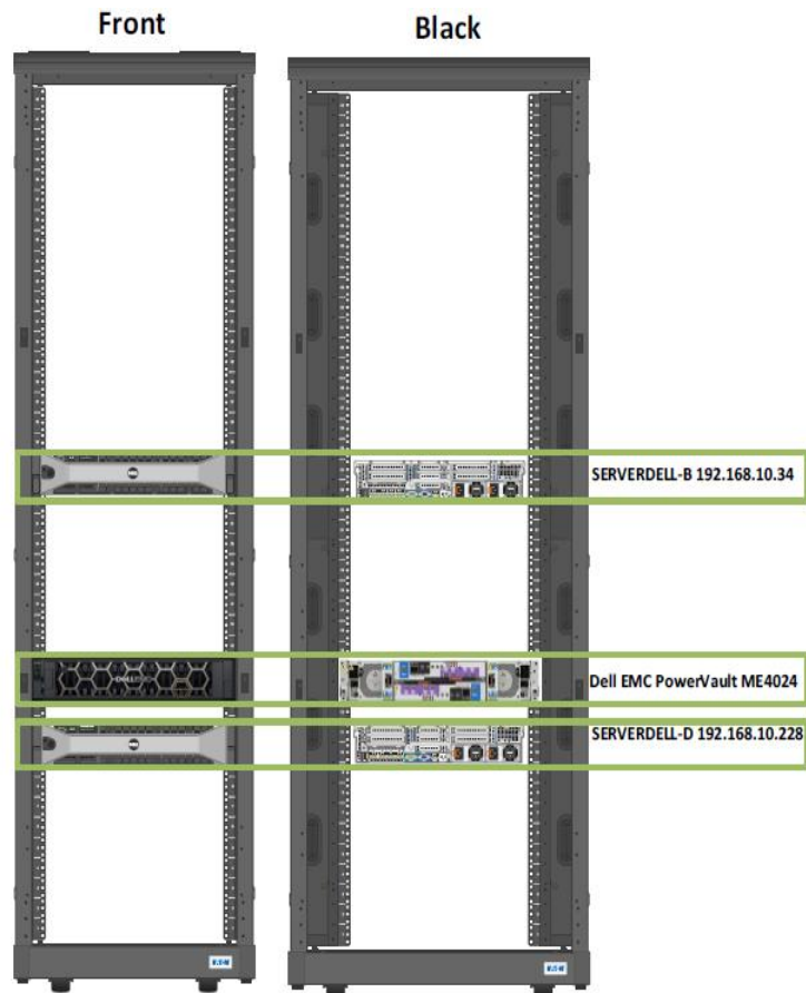
Ilustración 3 – Instalación Física en Rack
